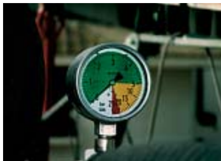
Fig. 20 - Manometro, per la verifica della pressione di esercizio.
